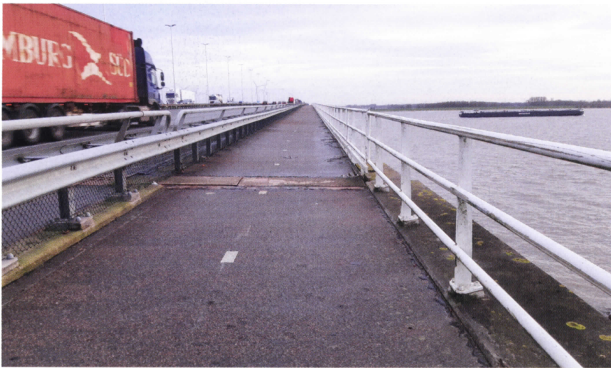
▲ De reling van de Moerdijkbrug is te open en geeft daardoor een onveilig gevoel. Dit is één van de kritiepunten van de Fietsersbond
