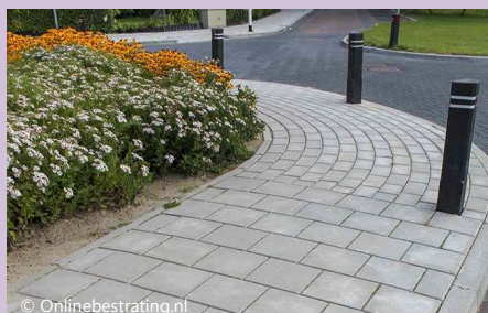
© Onlinebestrating.nl Onderhoud op peil Vlak en voldoende stroef trottoir.
